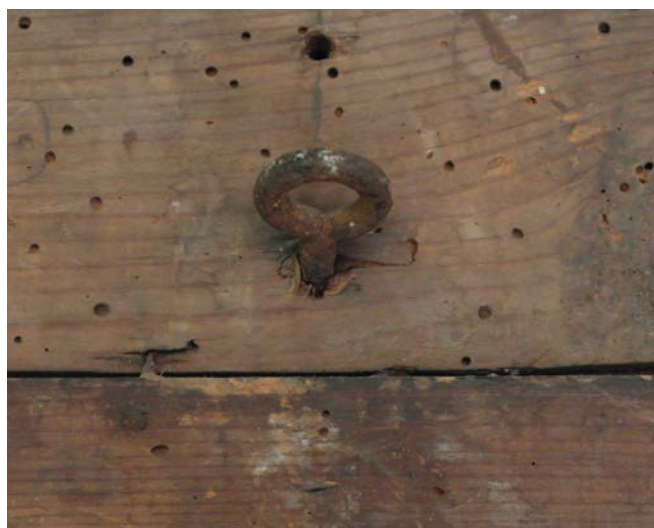
Fig. 13 - Detalle del cáncamo oxidado
