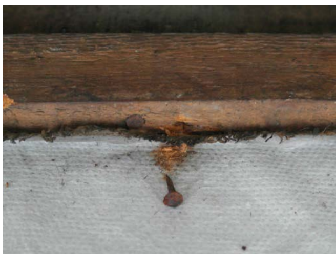
Fig. 17 - Detalle de un clavo oxidado
